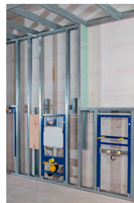
[FIG. 15] Elemento sanitario in parete in costruzione a secco con fissaggio alla parete posteriore da parte del costruttore a secco.
